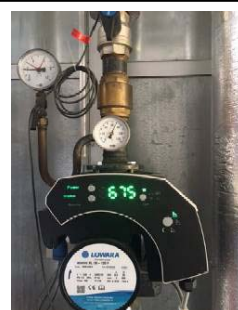
Details BGA und BHKW
