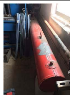
Wärmetauscher im Bereich Werkstatt
