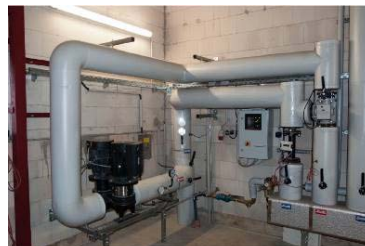
Bild 11: Pumpen am Vorlauf
