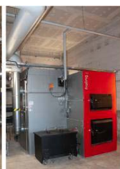
Bild 10: Großer Kessel und Aschebehälter
